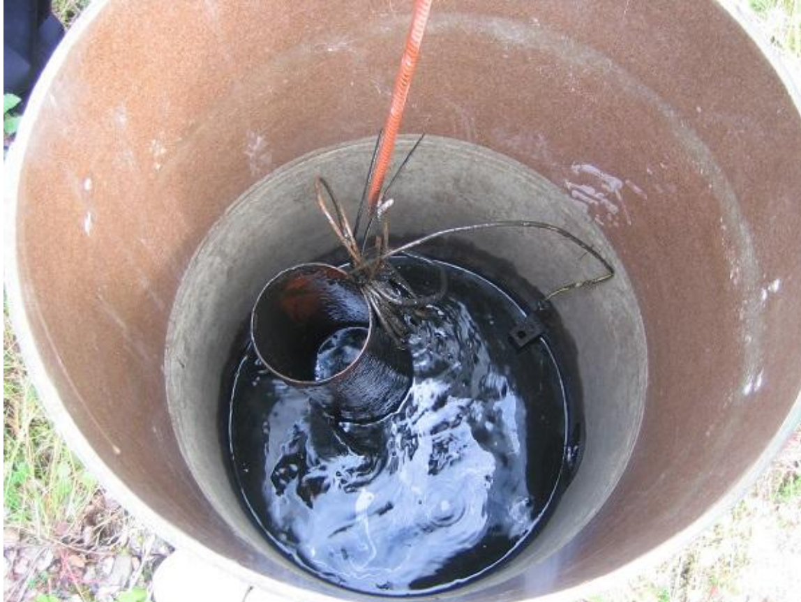
Öllykerroksen tyhjennysputki irti
