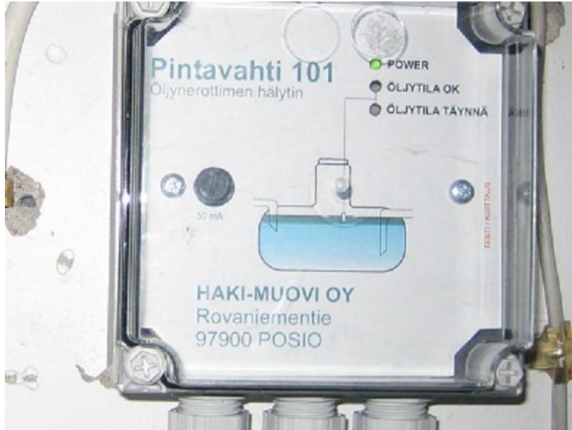
Öllykerroksen paksuuden hälytin
